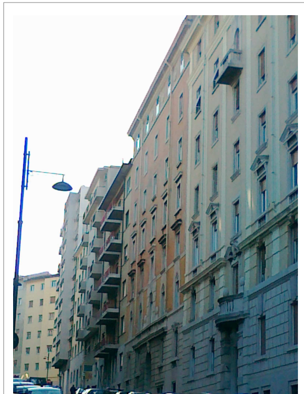
Vista generale della facciata di via Franca – si vedono le diversità cromatiche della parte superiore ed inferiore rispetto a quella centrale
